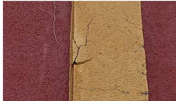
Figur 65: Betongskader i bæresøyler hovedbygg
