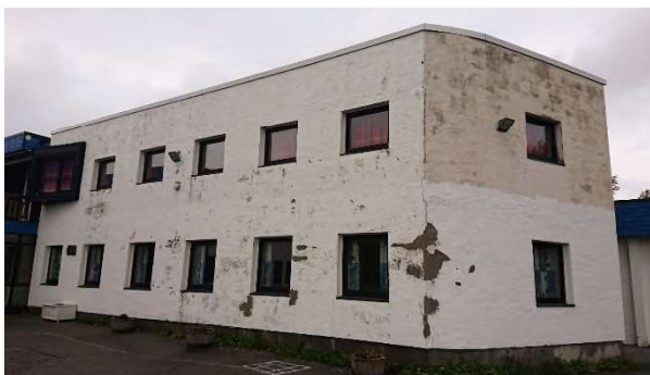
Figur 2: Store fuktskader i betongvegger. Behov totalrenovering fasader. Påvirker inneklime.
