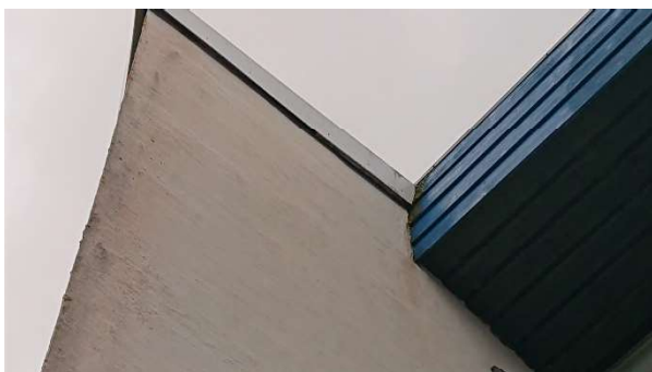
Figur 4: Lite isolasjon i tak. Lokale vannlekkasjer.
