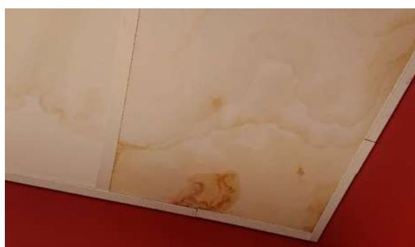
Figur 89: Generelt bra tak/fasader, men lokal lekkasje
