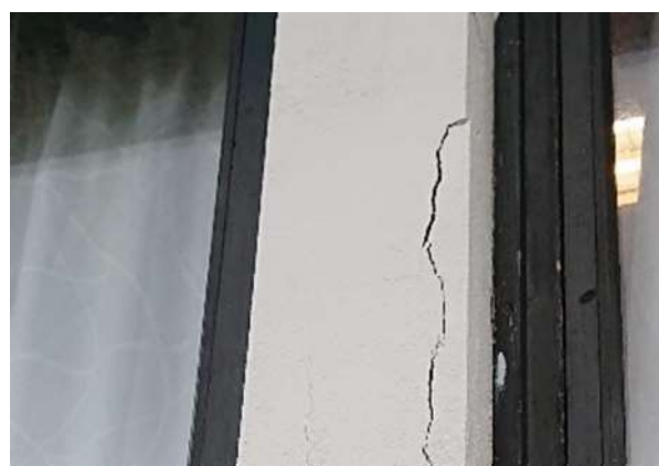
Figur 6: Betongskader fasade/søyler SFO-bygg
