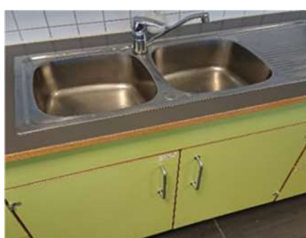
Figur 90: Stedvis innvendig slitasje, bl.a kjøkken
