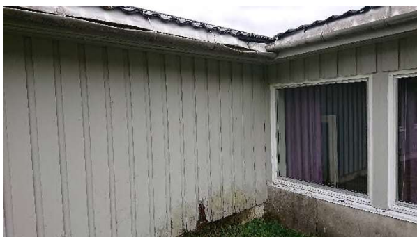
Figur 21: Defekte takrenne, lokal råte kledning og vindu. Manglende drenering/fall fra vegg
