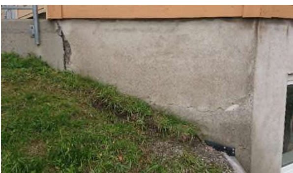
Figur 70: Bom/sprekker puss, byggetrinn 2
