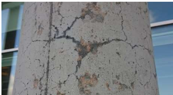
Figur 54: Bygg generelt bra, men registrert riss/krakelering betong bæresøyler
