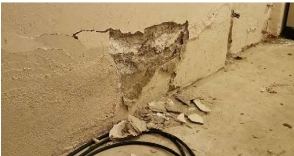
Figur 32: Omfattende fuktskader i kjeller
