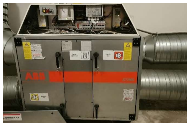
Figur 42: Bhg: Ventilasjonsanlegg tilsynelatende ok stand, men nærmer seg forventet levetid
