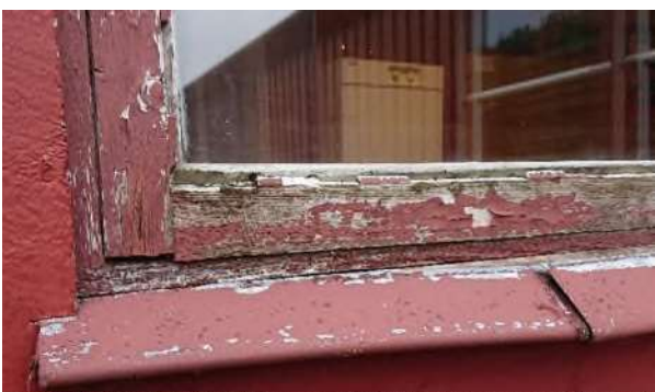
Figur 31: Delvis svært dårlige vinduer
