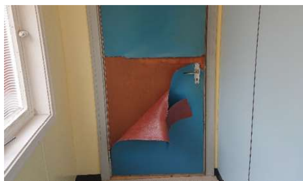
Figur 62: Gymbygg er nedslitt innvendig
