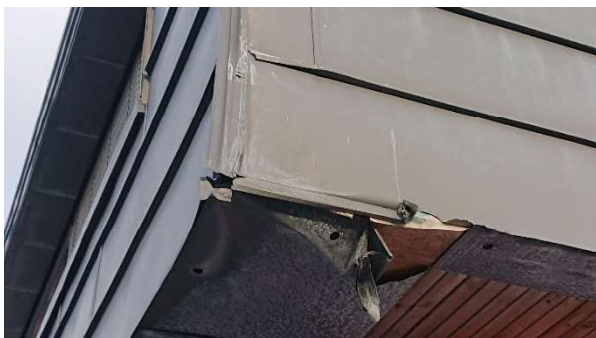
Figur 84: Generelt bra fasader, noen lokale skader
