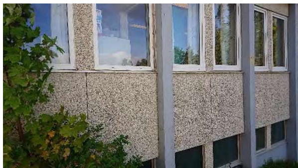
Figur 46: Behov renovering fasader
