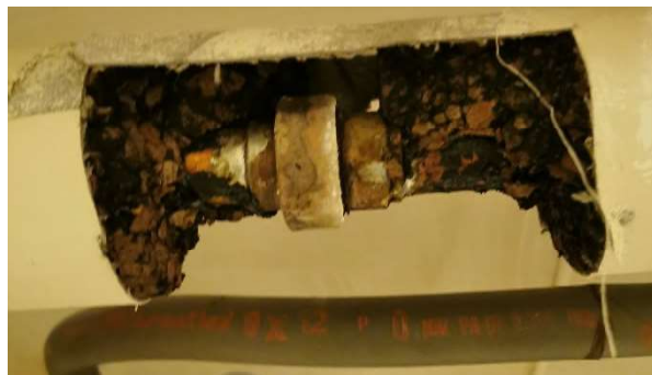
Figur 37: Hull i vegg over el hovedtavle, fuktinntrenging
