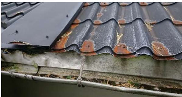
Figur 19: Taktekking og takrenner moden for utskifting
