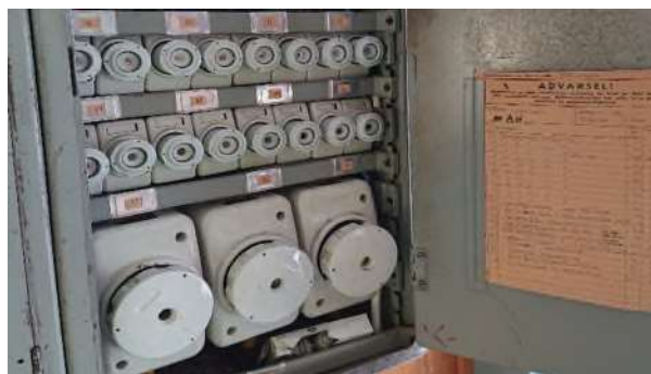
Figur 63: 55 år gammelt el-anlegg i gymbygg
