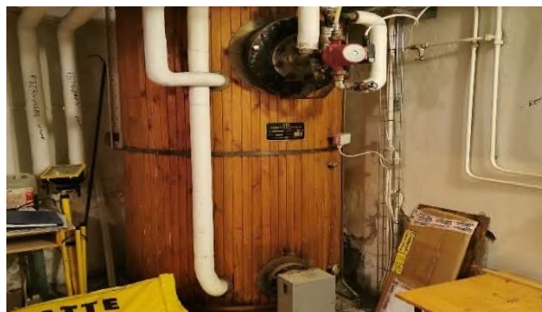
Figur 36: 56 år gamle tekniske installasjoner
