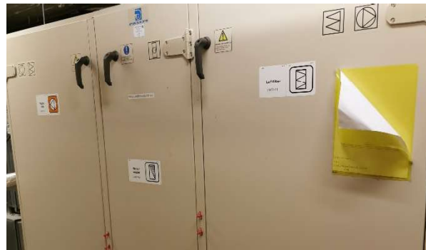
Figur 67: Hovedbygg, ventilasjonsanlegg fra 2002
