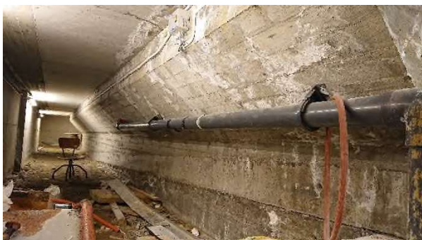
Figur 22: Tilstand basseng bør kartlegges nærmere
