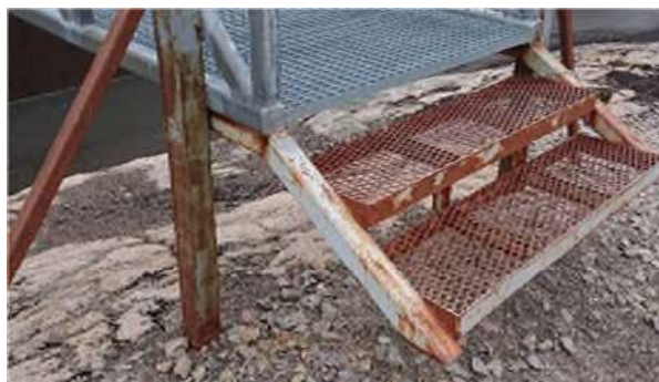
Figur 91: Korrosjon utvendige gangbroer
