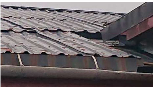
Figur 33: Stålplatetak i svært dårlig forfatning
