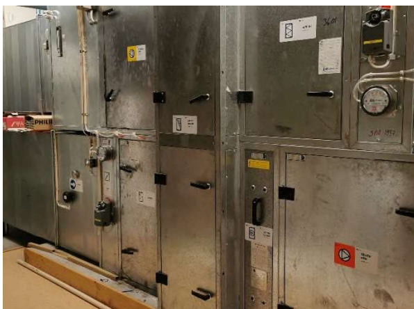
Figur 80: Ventilasjonsanlegg nådd forventet levetid
