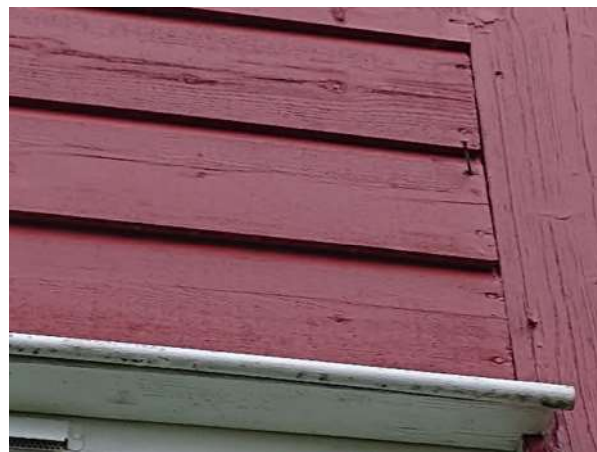
Figur 41: Barnehage med utvendig vedlikeholdsbehov
