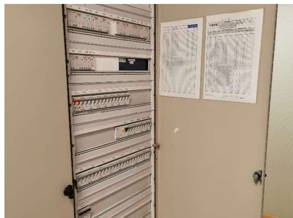
Figur 81: Strømskap med automatsikringer
