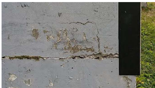
Figur 48: Skader i betong og murverk
