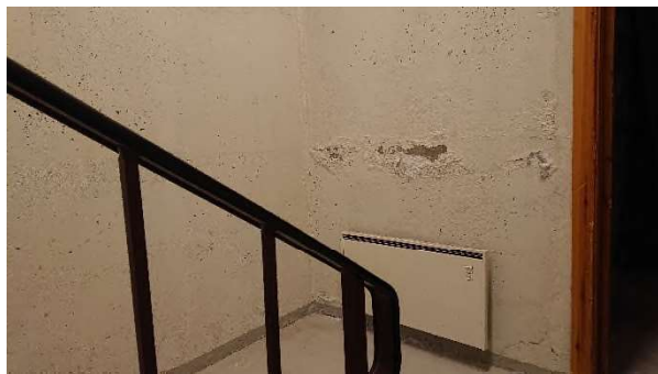
Figur 49: Fuktutslag i kjellervegger og dekke
