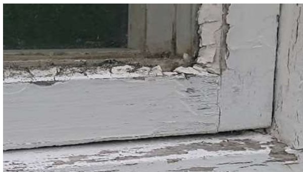
Figur 61: Gymbygg med dårlige vinduer
