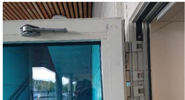
Figur 56: Skader, svak hengsling ytterdører
