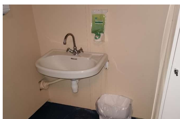
Figur 43: Bhg: Behov utskifting sanitærutstyr
