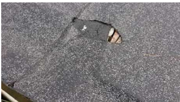
Figur 87: Skader tak garasje/lager
